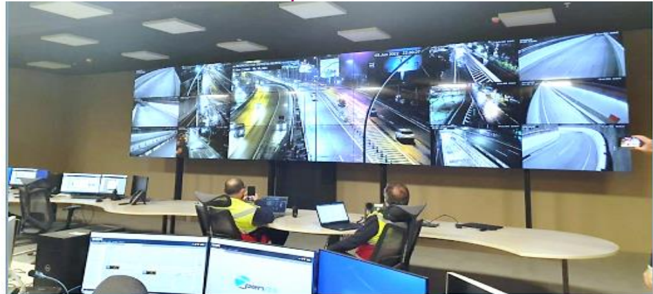
Centro de Control Túnel Americo Vespucio Oriente - Chile
